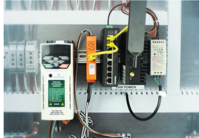
El switch industrial TI-PG80 de TRENDnet instalado en DIN-Rail como parte del sistema de monitorización inteligente SAM4.
