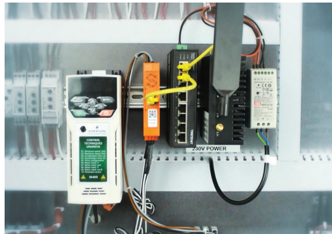
Le switch industriel TI-PG80 de TRENDnet est installé sur un rail DIN en tant qu'élément du système de surveillance intelligent SAM4.
